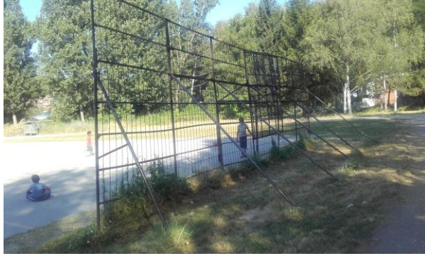
Слика 11. Изглед дотрајале заштитке ограда
