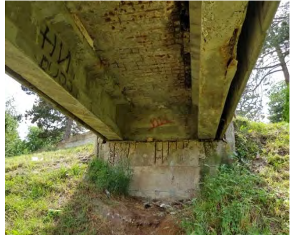
Слика бр.8: Оштећења обалног стуба, главних носача и коловозне плоче крајњег поља моста
