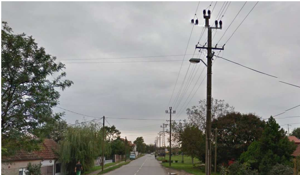
Slika 7. Izgled aktuelnih elemenata javne rasvete
