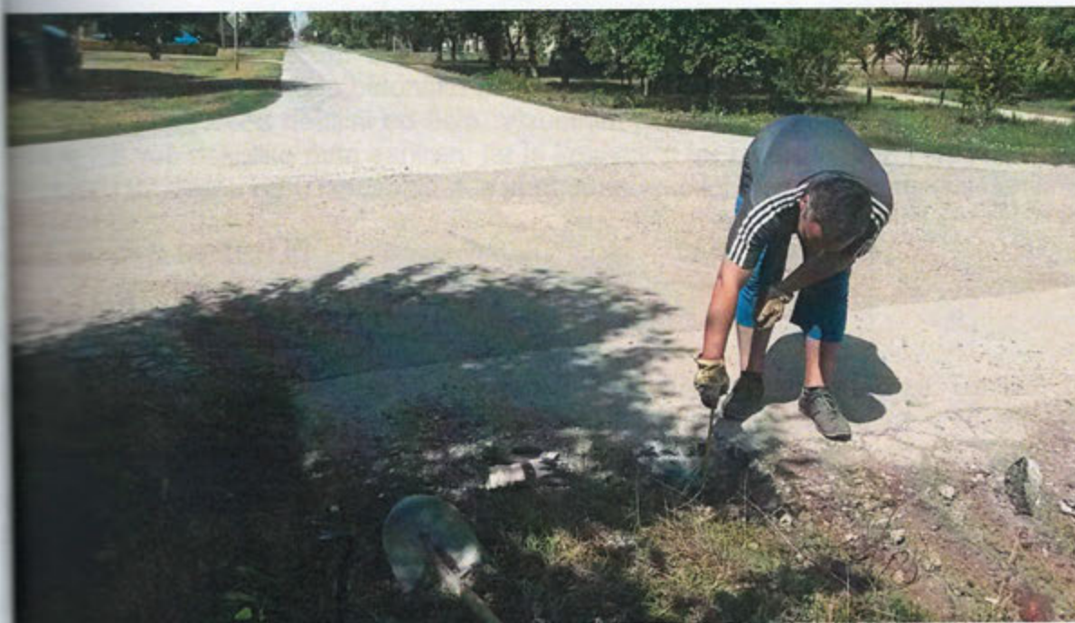
Slika 2: Istražna jama uz cevasti propust Ø600, u ulici Doža Đerđa
